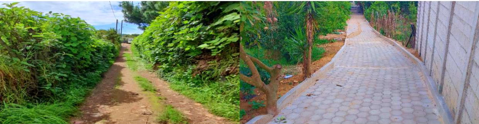
Nombre del proyecto: MEJORAMIENTO CALLE CON ADOQUINADO EN 5A AVENIDA A FINAL DE LA ZONA 1, SAN BARTOLOME MILPAS ALTAS, SACATEPEQUEZ. Fecha de inicio: 09 de marzo del 2023 Fecha de finalización: 04 de julio del 2023.
