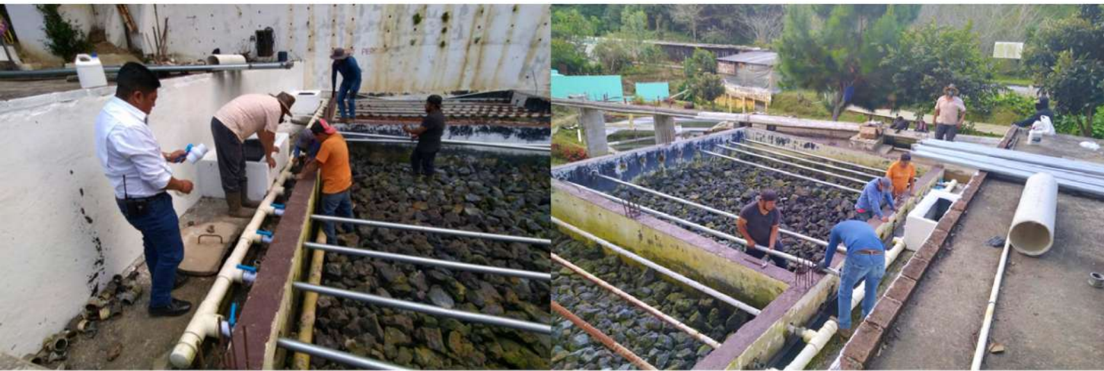
APOYO A LA UNIDAD DE UGAM CON EL MANTENIMIENTO A LAS PLANTAS DE TRATAMIENTO D E AGUAS SERVIDAS
