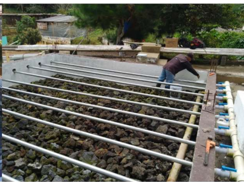
Planta de Tratamiento No. 2
