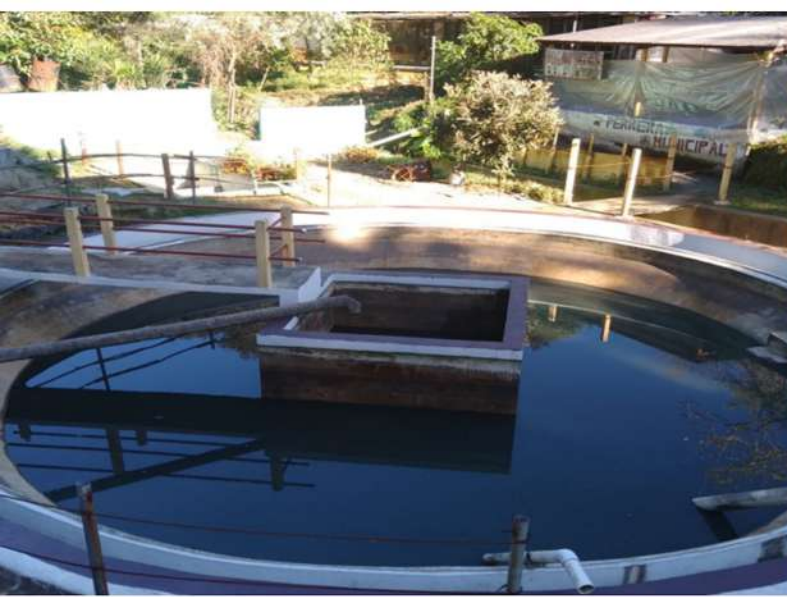
Planta de Tratamiento No. 1
